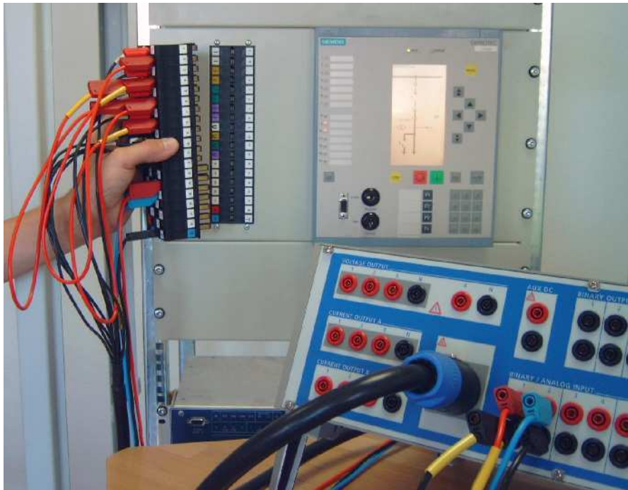
Bild 1: Schutzrelais, Prüfleiste mit Stecker und Prüfgerät
